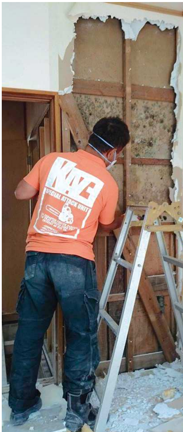
壁をはがすとカビが生えている
