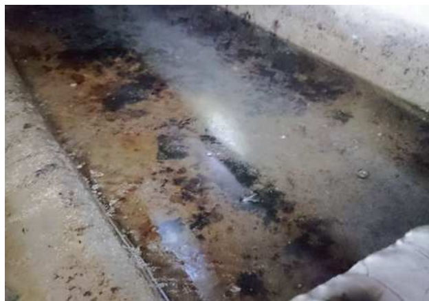
水が残って悪臭が発生する
