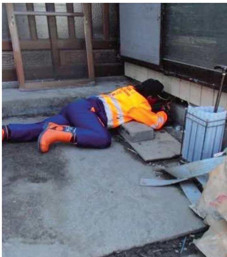
通風口から床下の泥を確認する
