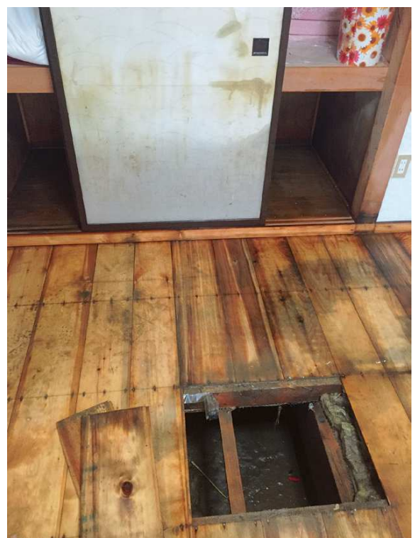
室内の被害状況も撮っておく
